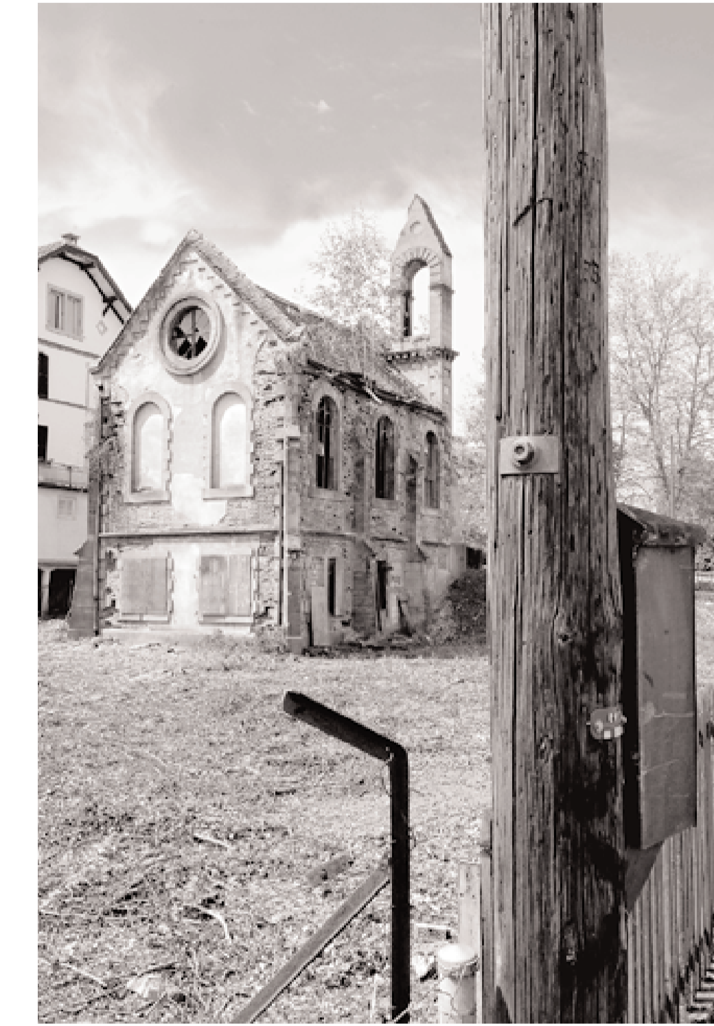
Unsanft aus langem Schlaf gerissen: Das Holliger Gotteshaus steht vor dem Aus. ADRIAN MOSER
